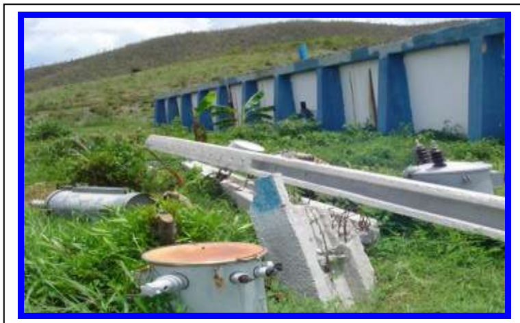
Foto 8. Base de acueducto con el sistema de alimentación eléctrica por encima de los sistemas de almacenamiento y distribución.
