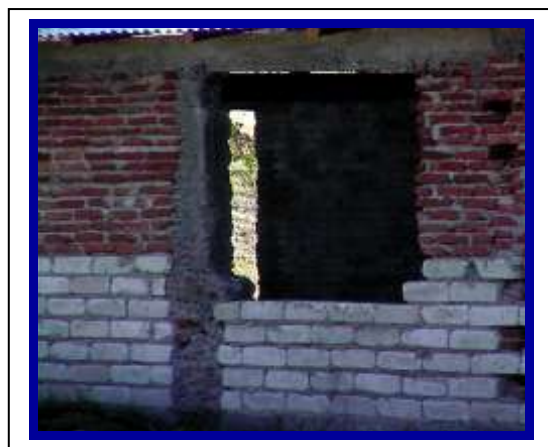
Foto.7 Construcciones hechas con materiales de pobre calidad y sin los requerimientos técnicos establecidos.
