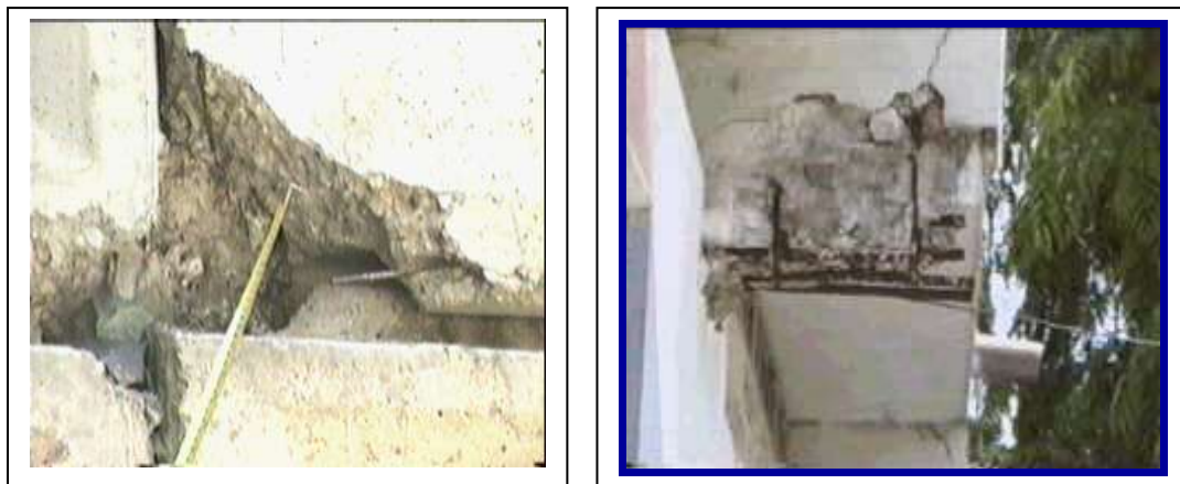
Foto. 3, 4. Deterioro de los elementos estructurales en edificios y viviendas familiares. Edificios del Sistema Constructivo Gran Panel Soviético. Obsérvese caída del mortero de recubrimiento en las juntas entre paneles estructurales, en el exterior del edificio, provocado por la corrosión del acero de refuerzo.
