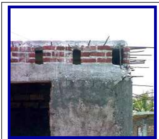
Foto. 6 Construcción en el área de desarrollo, con técnicas no apropiadas para zonas sísmicas.
